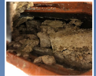
(Kellerkanal voll Ablagerungen, noch „rechtzeitig“ festgestellt)
